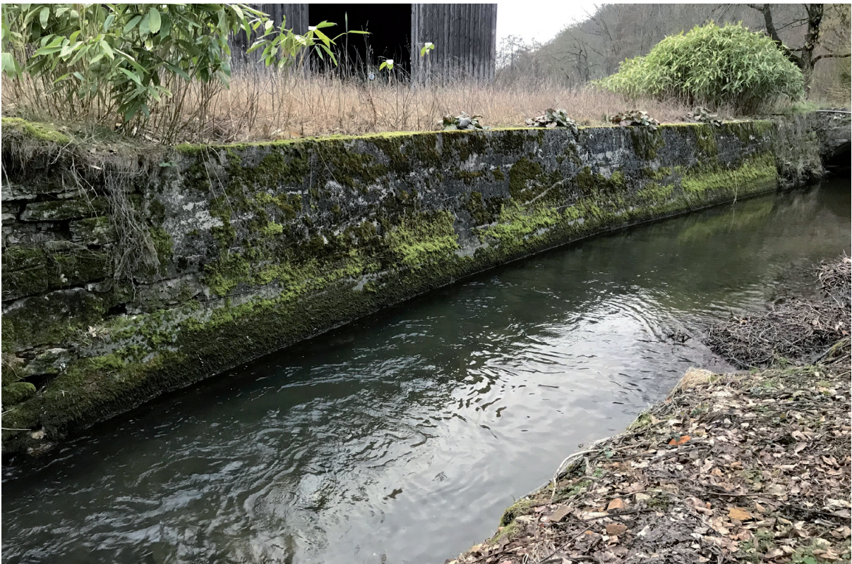
Abb. 2.3: (BÜRO FÜR FREIRAUMPLANUNG, 2019): Diese ca. 35 Meter lange Mauer, die als Objektschutz der Scheune dient, sollte durch geeignete ingenieurbio-logische Bauweisen ersetzt werden.
