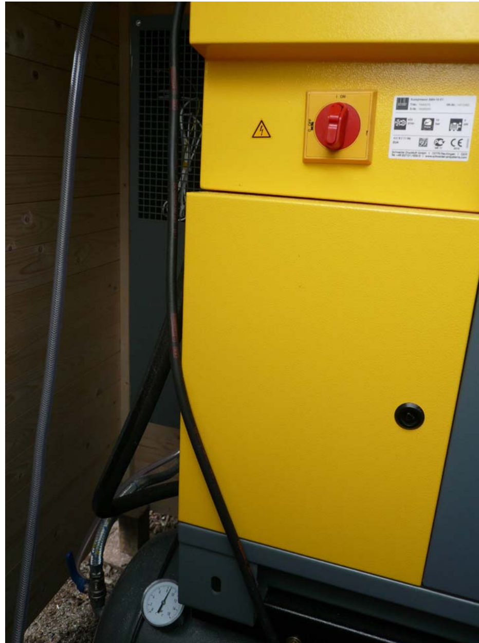
Kompressor für die Begasungsanlage, Vordruck 9,1 bar, Druck in der Begasungsanlage 2 bar, Luftdurchsatz 500 l/min, Leihgabe der Fa. Grotemeier Lemförde
