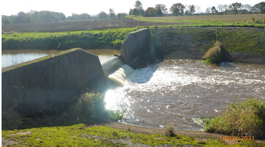
Abbildung 6: Wehr 4 Klärwerk Barver
